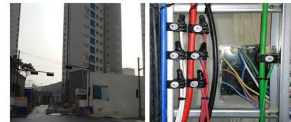
포스코건설 집합건물 전력 및 접지
